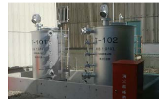
廃油油水分離設備
